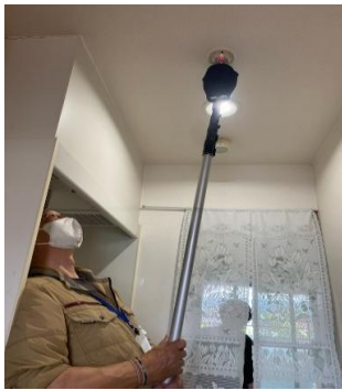
居室にある煙・熱感知器の点検
