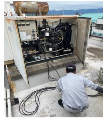
屋上にある自家発電機の点検
